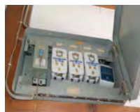
① 古い分電盤
