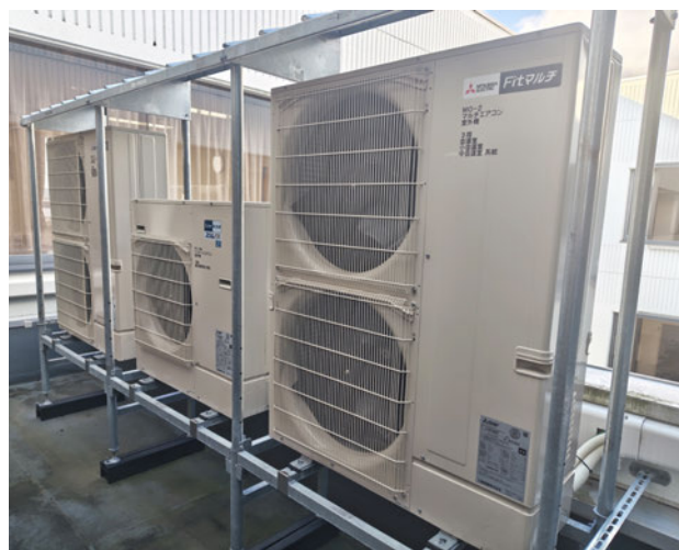
役場のエアコン室外機
