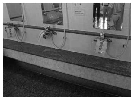
サンホールはびねす故障箇所
