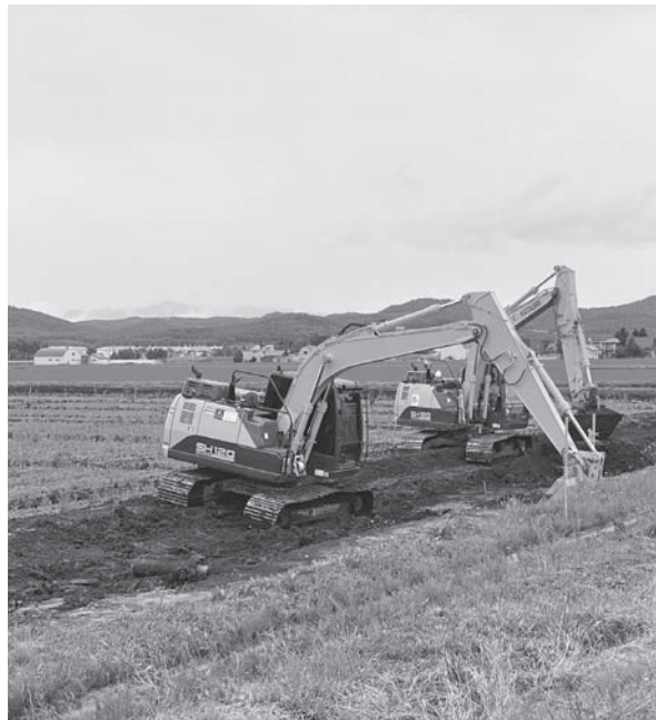
鷹栖南地区の基盤整備工事の様子 4～7枚の水田を1枚にすることで作業の効率化につながります
