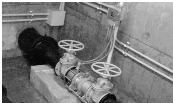
配水管と配水流量計
