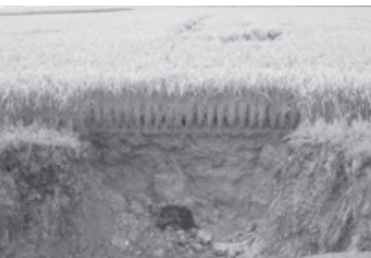
14線7号 8号川 崩れた畦
