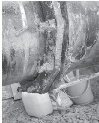
腐蝕した铸铁管継手
