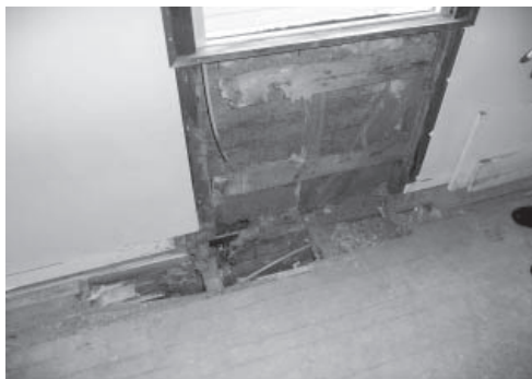
蟻害が発生した詰所
